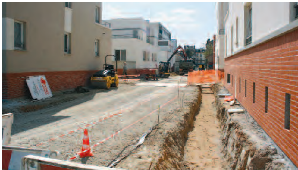
Prolongement de la rue George Sand : une nouvelle vie au quartier Dans le quartier Seine, la rue George-Sand était jusqu'à aujourd'hui une impasse. Sombre, peu engageante. Dans peu de temps, ce sera une rue ouverte sur les autres, qui dessert de nouveaux logements. Le quartier de la gare fait peau neuve.
